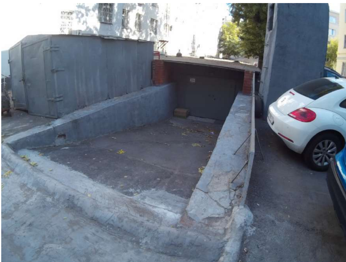
ЦТП Доватора 12 корп.2
